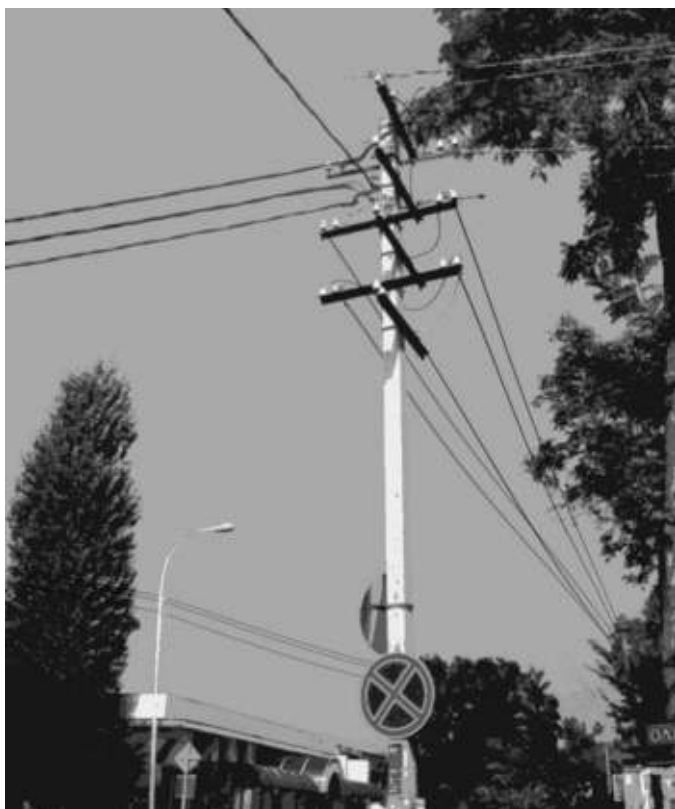
Опора, где пересеклись эпохи и технологии (слева – СИП, справа – неизолированный провод)
